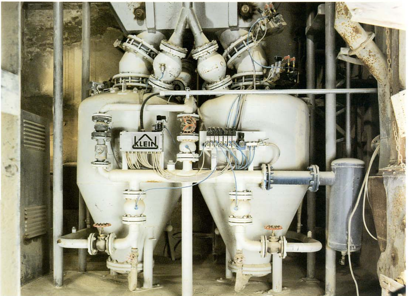
Tandem-Gefäß-Förderanlage in einem Kalkwerk Twin vessel conveyor line in a limestone works Installations de transport fonctionnant en tandem dans une fabrique de chaux
